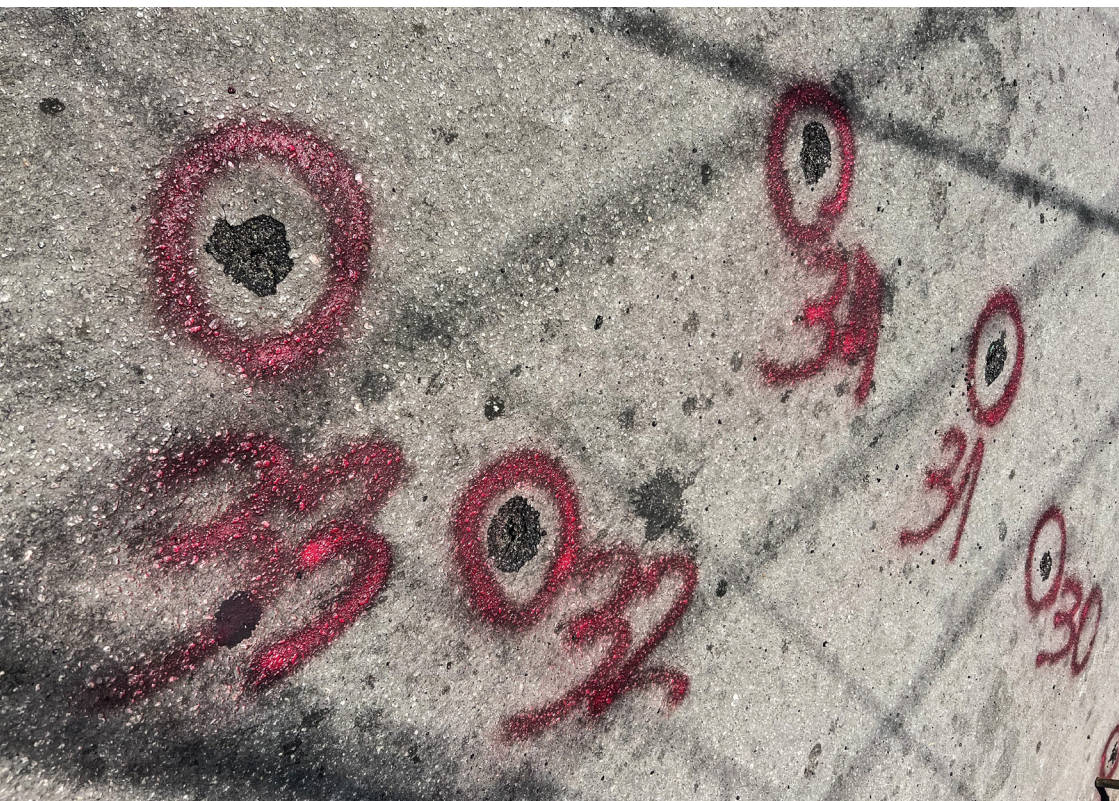
Marcas de tiros no asfalto deixadas pelo helicóptero nas ruas Roberto da Silveira c/ rua Maurício Nassau, Parque União
