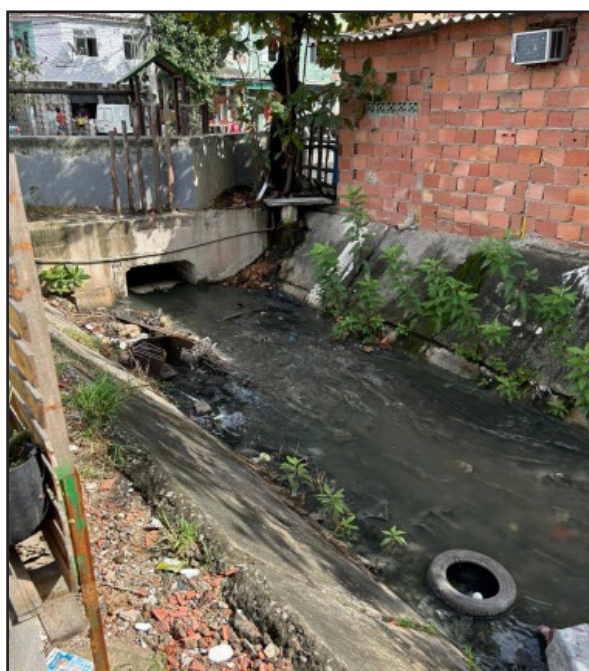
Figura 11. Valão de esgoto a céu aberto. (Fonte: EcoClima)
